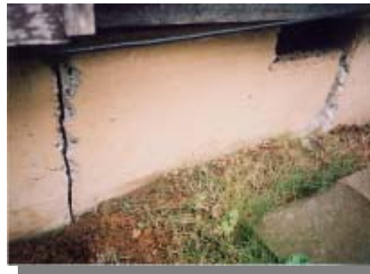
新潟中越地震で鉄筋が足りない住宅
